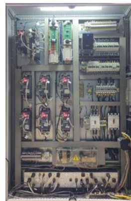
Рис. 14. Шкаф управления ЛК-5В
