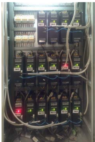
Рис. 16. Система управления СТБ ТС2-220
